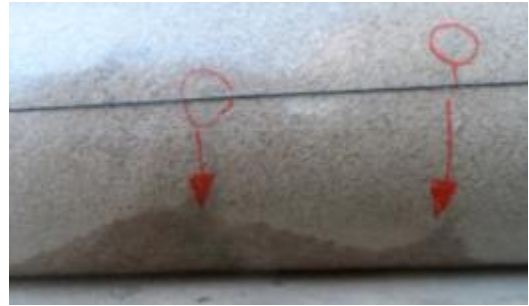
Entrée d'eau dans des sacs PE légèrement percés
